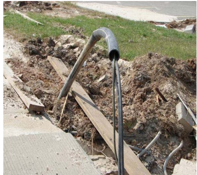
Este es un ejemplo de cables eléctricos dañados y desenterrados.
