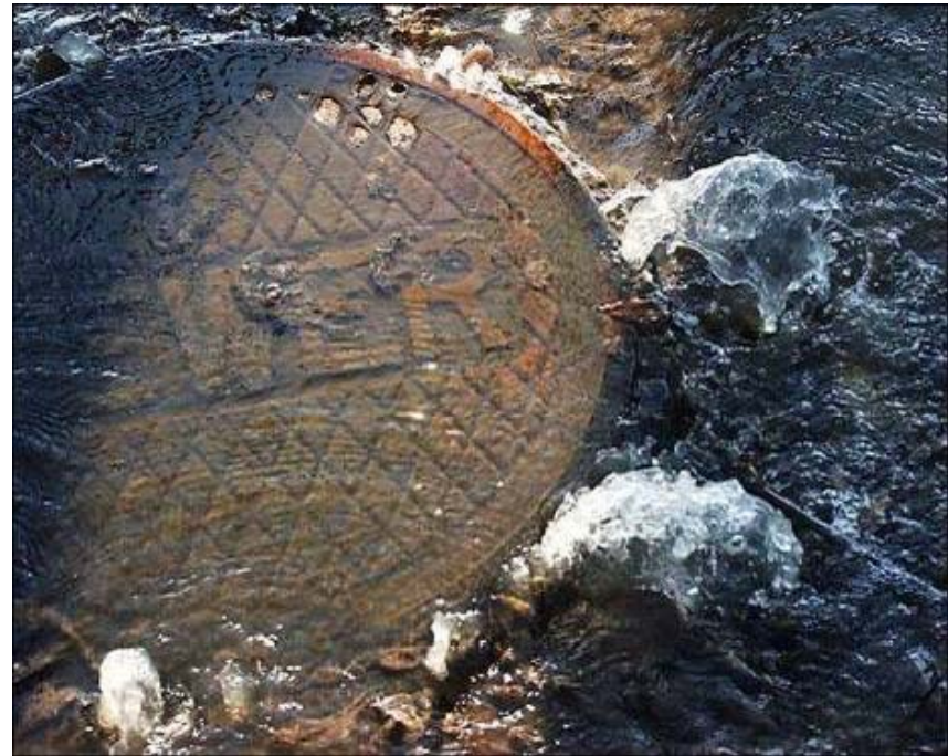
Una alcantarilla tapada hace burbujas en la carretera U.S. Highway 90 en Gulfport.
